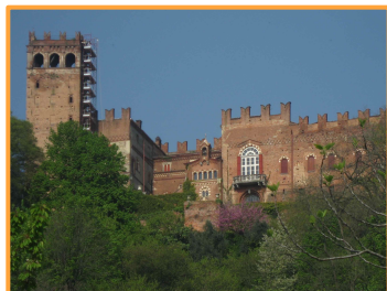
Castello di Camino ( AL ) Consolidamento travi copertura con sistemi compositi (FRP ) e rifacimento manto.
